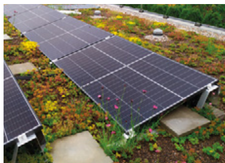
2) Tato dodatečně instalovaná fotovoltaika na zelené střeše je špatným řešením vzhledem k vysokému riziku zastínění panelu. Zdroj: GreenVille
