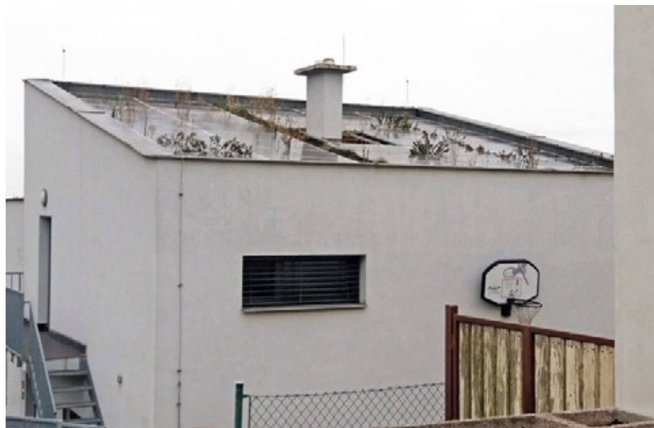
5) Nefunkční kombinace zelené střechy a fotovoltaiky na RD v Praze. Fotovoltaika byla realizována dodatečně přes veškerou zeleň a údržba neprobíhá. Foto: GreenVille
