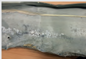
Detail bílé koroze TiZn plechu
