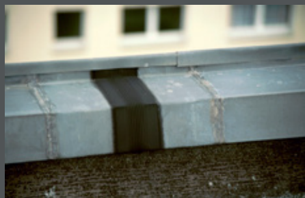
Dilatace správně použítá, ale každý nemusí vidět, že je zrovna černá. Vhodné překrytí by zvýšilo vzhled celé konstrukce.
