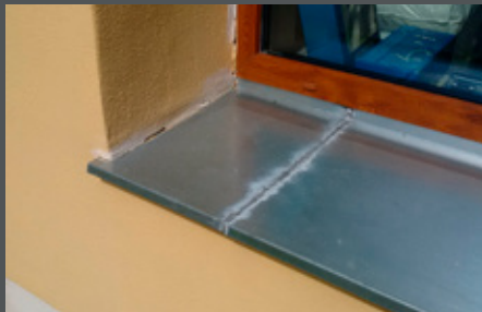
Dvakrát měř, jednou řež neplatí jen pro tesaře, ale i pro klempíře. Plech je navíc zatažen pod omítku bez ohybu, takže voda z parapetu bude brzy narušovat omítku v ostění.
