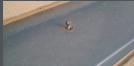
Plech při svých dilatačních pohybech povytáhl hřebík nechráněný krytkou. Cesta pro zatékání je volná.
