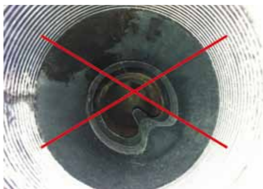
Obr.1 - nesprávné použití vtoků při rekonstrukci
