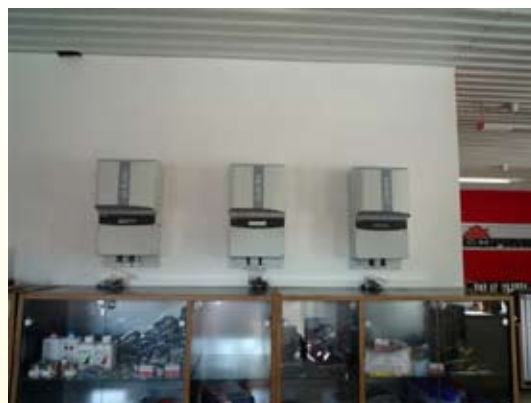
O přeměnu energie z panelů se starají měniče dodávajících vyrobenou elektřinu přímo do rozvodu v budově....
