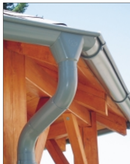
Výborný okapový systém s vnějším rohem větším než 90°. Práce provedla firma Kratochvíl střechy z Prahy
